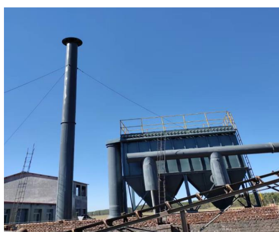
破碎筛选工序布袋除尘器+15m 高排气筒
